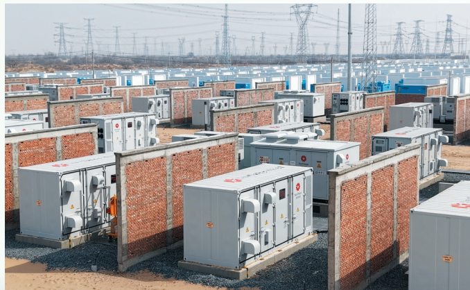
万马储能电站预制舱式设备区。
