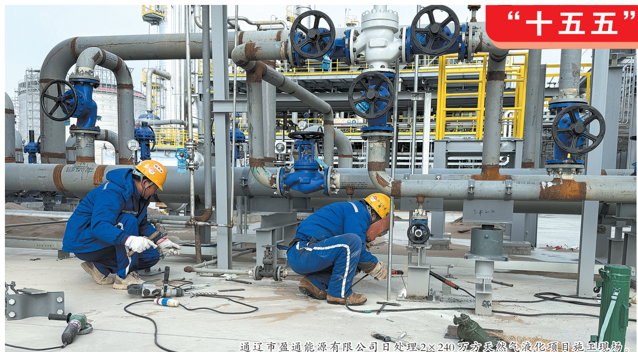
通辽市盈通能源有限公司日处理2×240万立方米天然气液化项目施工现场。
