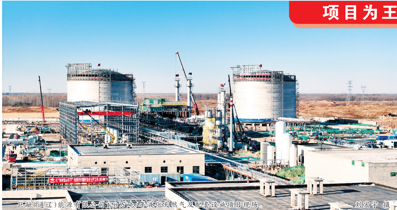
巨融(通辽)能源有限公司120万吨/年液化天然气及配套设施项目现场。刘宏宇摄
