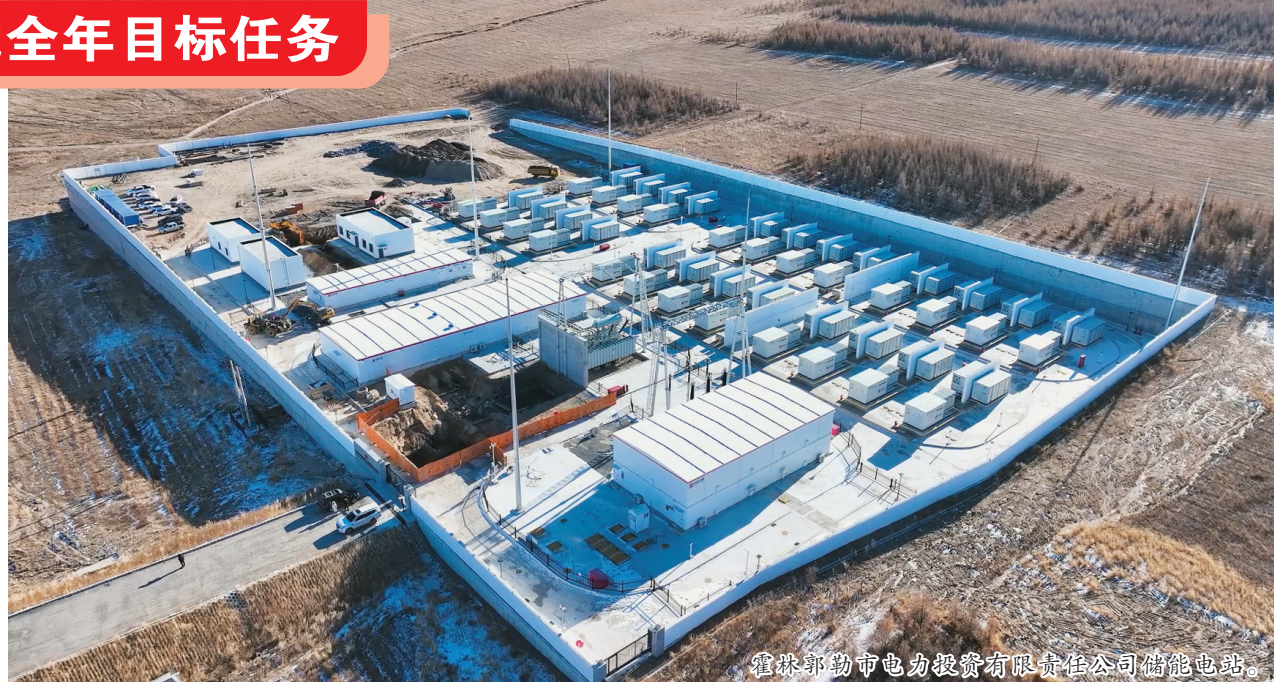
霍林郭勒市电力投资有限责任公司储能电站。
