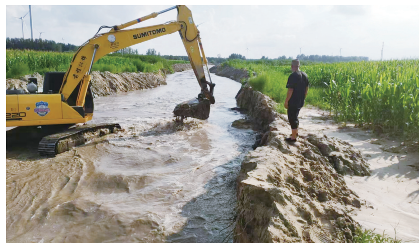
今年7月,正在施工中的白音塔拉农场八分场黑喇嘛河排涝工程。
